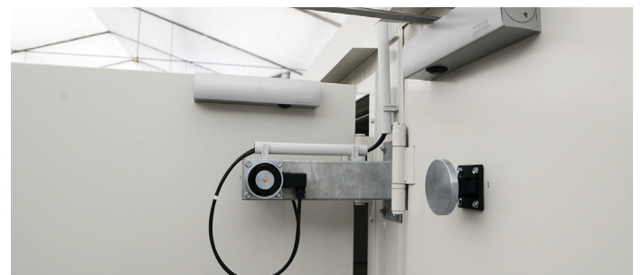
Türfeststellanlage mit Magnethaltearm, automatische Türschließung im Brandfall
