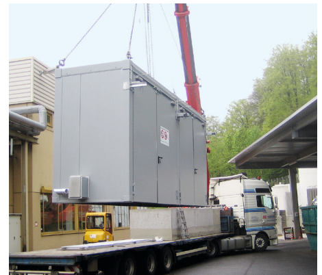
Gefahrstofflager Regal BLS R2, betriebsfertige Anlieferung eines Doppelregallagers
