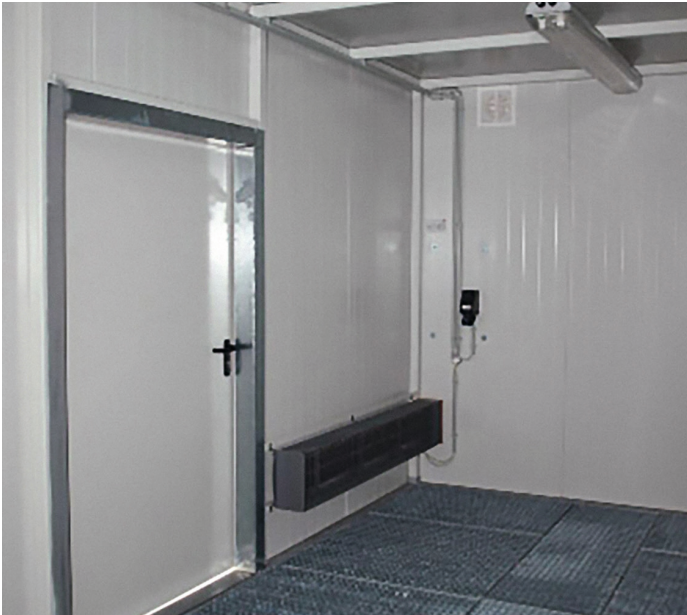
Innenansicht mit Langfeldleuchte und Rippenrohrheizkörper
